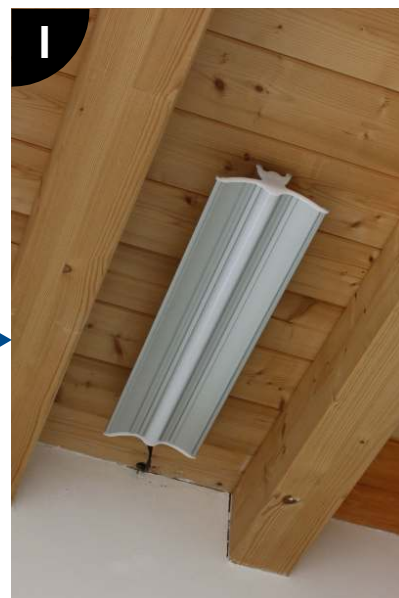
Collegamenti elettrici e controlli
